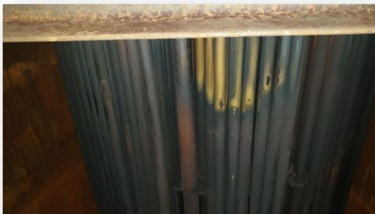
Рисунок 1 – Эрозионный износ теплообменных трубок в серийном ХЭ -70-550
